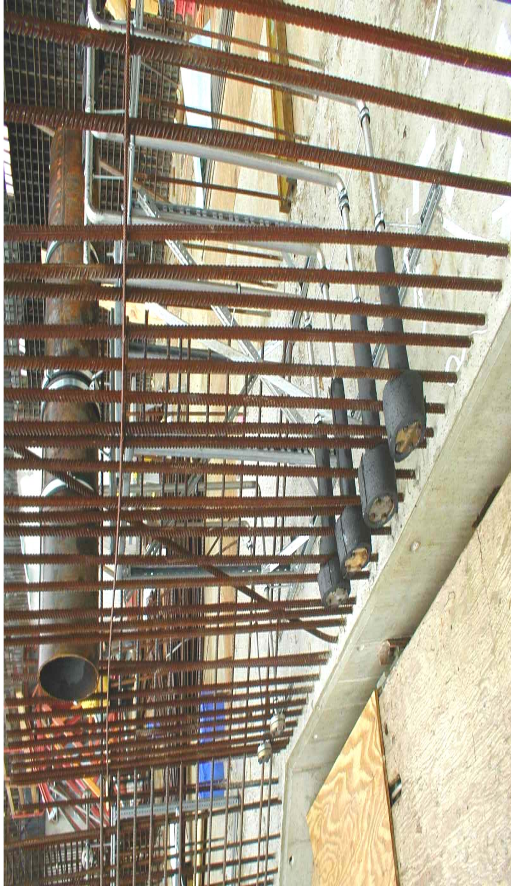
Bild 9: Bewehrungsdurchdringung Leitungen mit Vorschweißflansch
