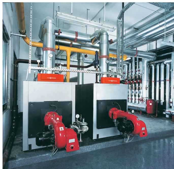
Bild 4: Zwei Gas-Brennwertkessel Vitocrossal 300 mit jeweils 895 kW und ein Niedertemperatur-Heizkessel Vitoplex 300 (720 kW, nicht abgebildet) sorgen bei Ingersoll Cutting Tools für zuverlässige Wärmeversorgung.
