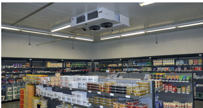
Bild 11: Kühlraum Molkereiprodukte +2°C.
