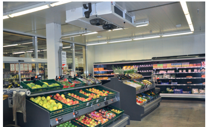
Bild 12: Kühlraum Obst + Gemüse +8°C.
