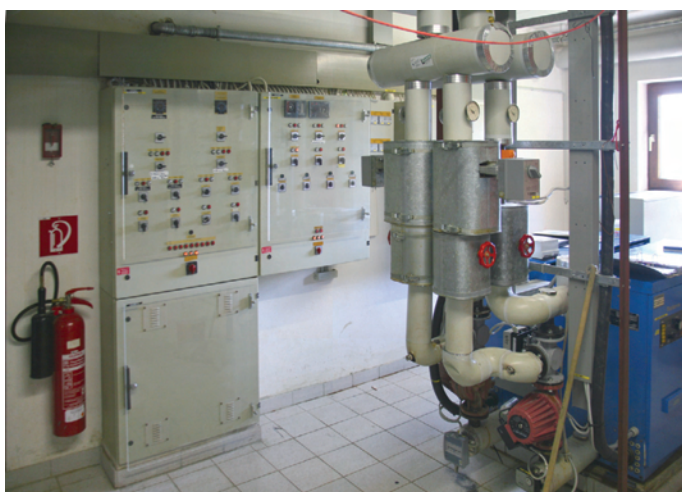
Altanlage auf der Wankstation.
