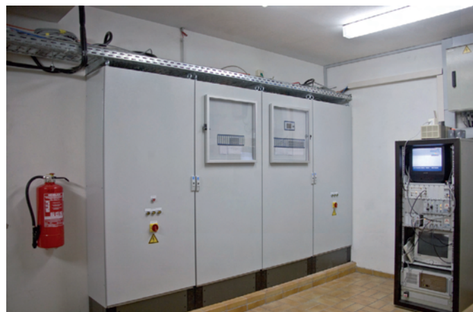
Schaltschrank auf der Zugspitze.
