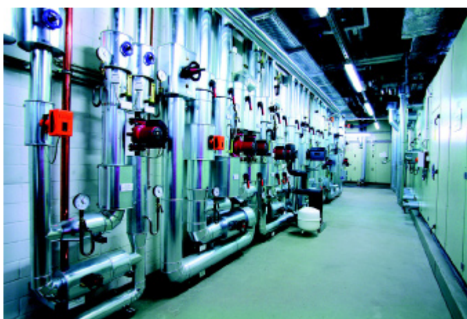
Bild 2: Blick in eine Heizzentrale – hier ist u.a. die Dämmung der Rohrleitungen für kaltes Trinkwasser Teil der Überprüfung.
