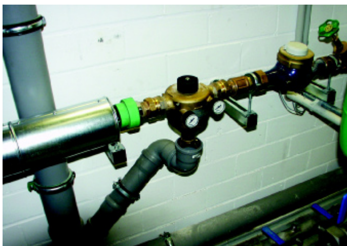
Bild 3: Ist der Schutz des Trinkwassers durch Nicht-Trinkwasser sichergestellt? Auch dies ist ein wichtiger Prüfpunkt.
