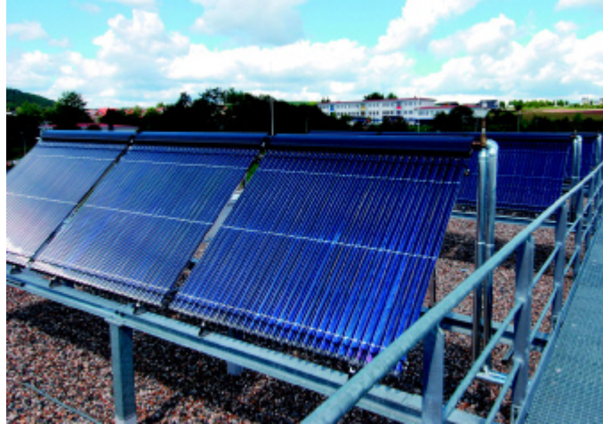
Bild 7: 45 Vakuum-Röhrenkollektoren auf dem Dach der Viessmann Akademie unterstützen die Heizung und versorgen im Sommer eine Absorptionskältemaschine und eine DEC-Anlage mit Antriebsenergie für die Gebäudekühlung.
