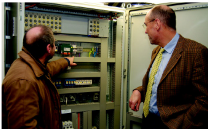
Spielt eine zentrale Rolle: die gemeinsame Regelung der gesamten TGA-Technik. Wie Beispiele aus Deutschland zeigen können hier entscheidende Fehler die benötigten Hygienebedingungen nachhaltig verhindern. (v. l. n. r.: Dipl.-Ing. Andreas Brüning, verantwortlicher Fachplaner, Dipl.-Ing. Norbert Dahlmann, technischer Leiter St. Marienhospital).
