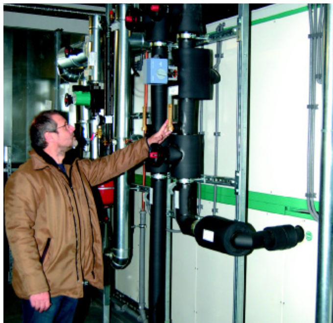
Mit der VDI 2167, bzw. der neuen DIN 1946-4 tritt eine neue Generation von Regeln an, die auf Erkenntnissen der Krankenhaushygiene beruht. Im St. Marienhospital in Hamm konnte ein einziges Planungsbüro alle TGA-Gewerke überwachen. Hier Fachplaner Dipl.-Ing. Andreas Brüning am Kühlregisteranschluss eines Lüftungsgerätes der neuen Anlagentechnik.
