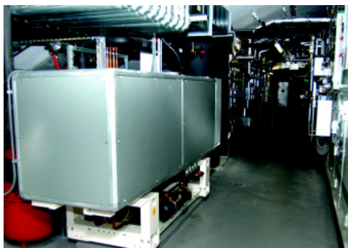
Der erste Einblick in die Technik zeigt auch im St. Marienhospital Hamm die gewohnte Komplexität raumluftechnischer Anlagen. Im Vordergrund Kaltwassererzeuger und dahinter ein Pufferspeicher.
