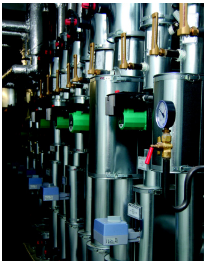
Eingebunden in das TGA-Gesamtsystem, um die strengen Hygienevorschriften zu unterstützen: die Heizungsunterverteilung der neuen OP-Räume.
