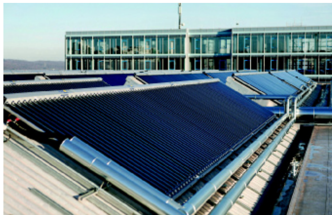
Bild 2: Ansicht Kollektorfeld mit Vakuumröhrenkollektoren einer Großanlage zur solaren Beheizung in -kühlung eines Bürogebäudes in Ostfildern.
