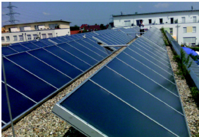
Bild 1: Ansicht Kollektorfeld mit Flachkollektoren einer Großanlage zur solaren Nahwärmeversorgung in Holzgerlingen.
