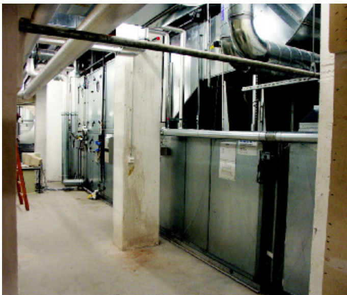
Abbildung 3: Blick in eine RLT-Technikzentrale.
