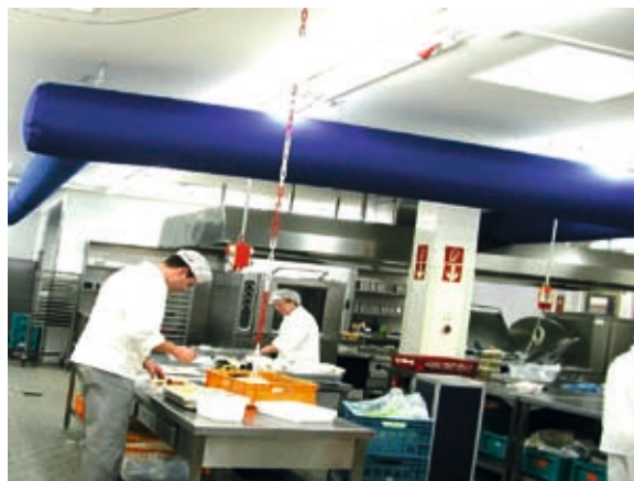
Bild 9: Textilauslass in einer Großküche.
