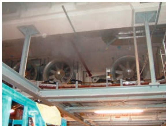
Bild 5: Abluftventilatoren mit 3 x 100 000 m³/h = 84 m³/s.
