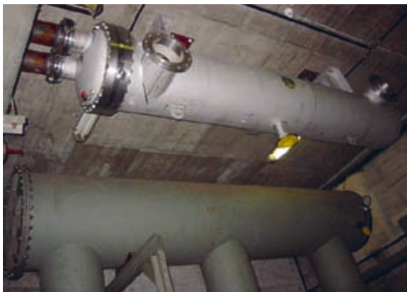
Herzstück der Wärmerückgewinnung: Der an der Decke montierte Edelstahl-Rohrbündelwärmetauscher vor dem Anschluss an die Dampfleitung.
