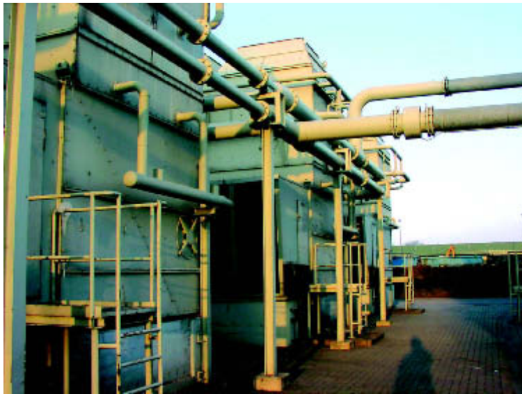
Abbildung 1: Kühlturmanlage der zentralen Kälteversorgung.
