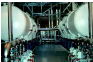
Bild 4: 2 x R718-Turbo-KWS mit je 1 MW Kälteleistung
