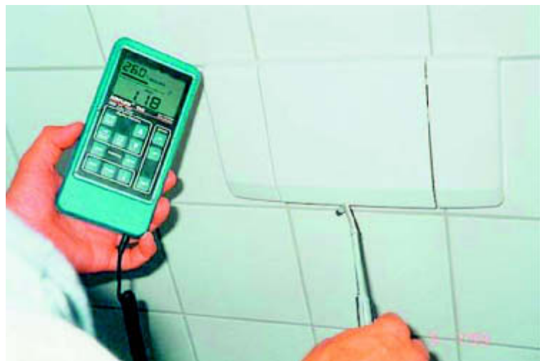
Zugerscheinungen im Bereich eines Spülkastens bei Vorwandinstallation.
