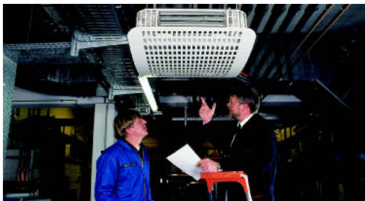
Dezentrale Luftbehandlungsgeräte bieten Legionellen keine Angriffsfläche.
