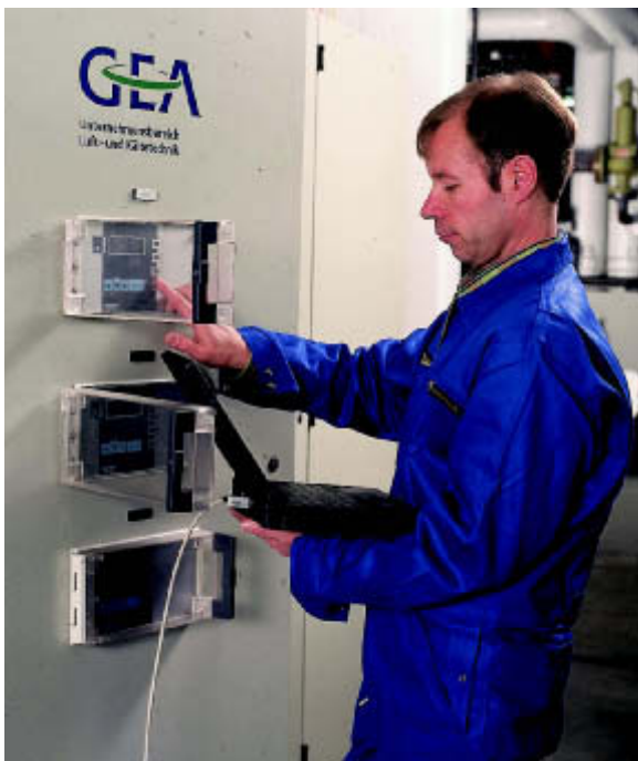
Zur Wartung von Zentrallüftungsanlagen sollten ausschließlich qualifizierte und geschulte Fachkräfte zugelassen werden. Sowohl das Unternehmen als auch die Monteure sollten gemäß VDI 6022 zertifiziert sein.
