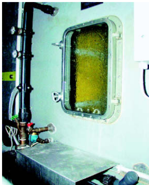
Durch den Intervallbetrieb können in Umluftsprühbefeuchtern Standzeiten auftreten, in denen sich Legionellen anreichern. Dies kann durch automatische Spülvorgänge und Wasserentkeimungsanlagen unterbunden werden.
