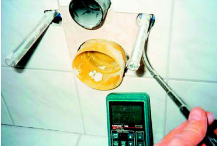
Beispiel einer Vorwandinstallation mit fehlendem Dichtheitskonzept.
