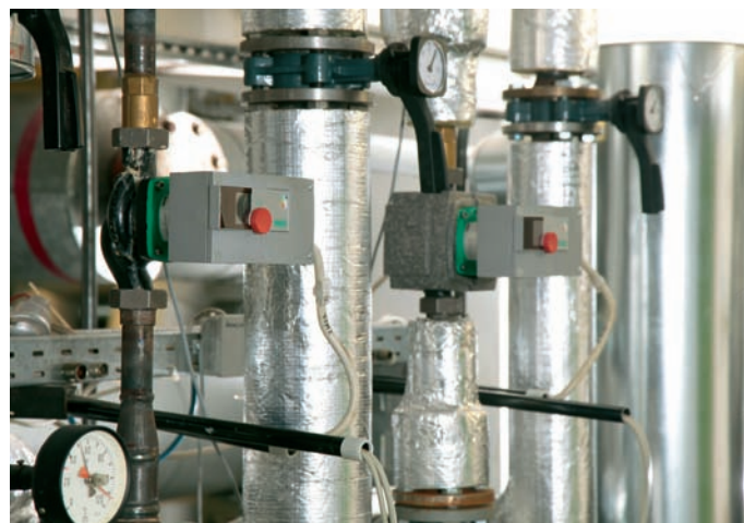
Abb. 3: Die Schule ist an das kommunale Fernwärmenetz angeschlossen. An der Übergabestation wird das Heizwasser von hoch-effizienten „Wilo-Stratos“-Pumpen auf die Heizkreise verteilt.
