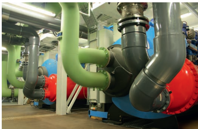
Bei komplexen Kälteanlagen müssen alle Komponenten optimal aufeinander abgestimmt sein, um hohe Energieeffizienzwerte zu erzielen.
