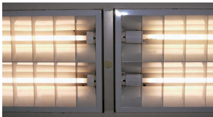
Leuchte nach Leuchtmittelwechsel. – Die alten 26 mm Leuchtstofflampen mit konventioneller Vorschalttechnik wurden durch neue 16 mm Leuchtstofflampen mit elektronischem Vorschaltgerät ausgetauscht. Hierdurch kann die Leistungsaufnahme der Leuchte deutlich gesenkt werden.
